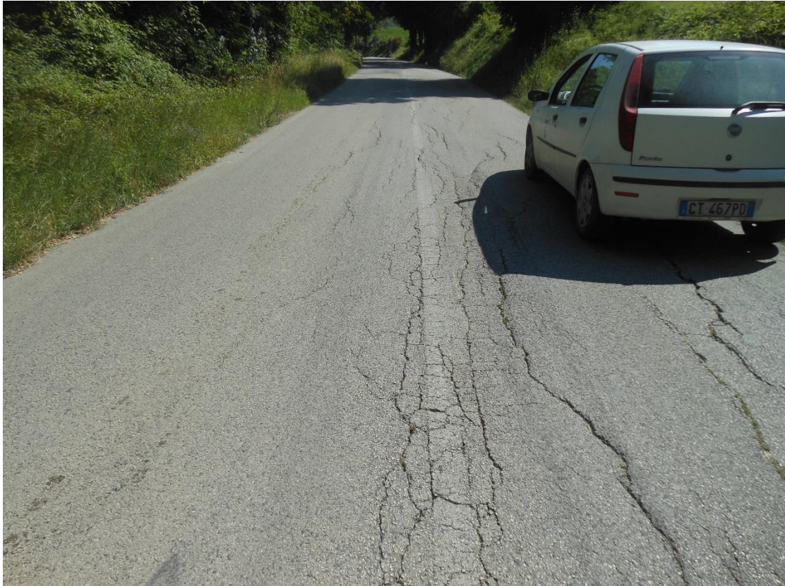
Foto 9. Km 14+700 - Fessurazione longitudinale della pavimentazione stradale.
