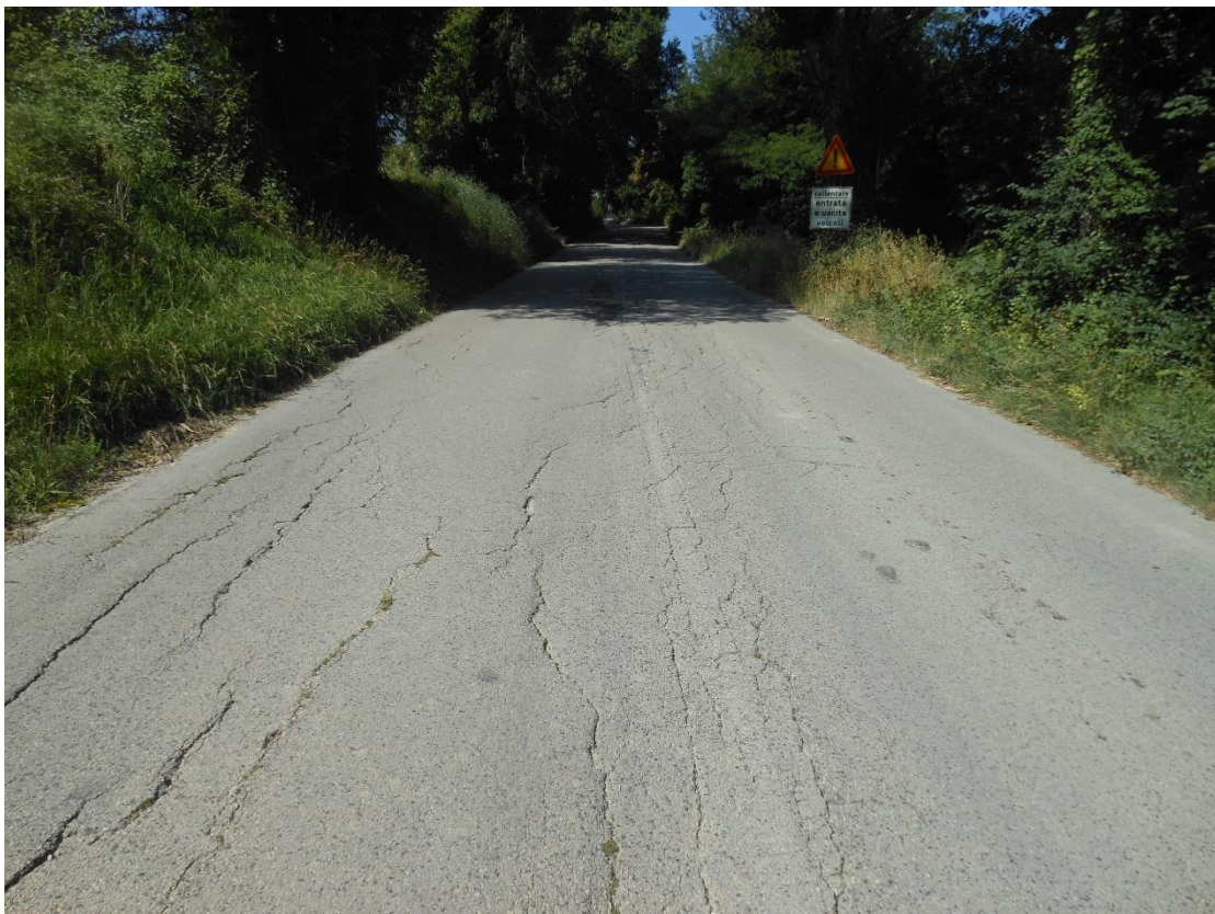
Foto 8. Km 14+200 - Fessurazione longitudinale della pavimentazione stradale.
