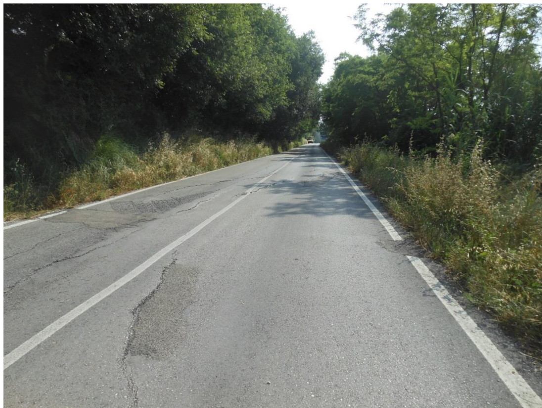
Foto 1. Km 2+100 - Avvallamenti della pavimentazione stradale con fessurazione longitudinale ed evidenze di sgranamento e usura della superficie.
