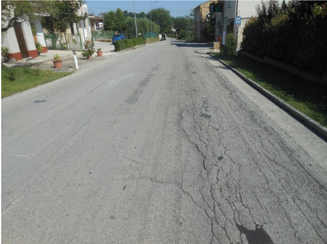
Foto 5. Km 4+600 - Fessurazione a ragnatela del bordo della pavimentazione stradale.
