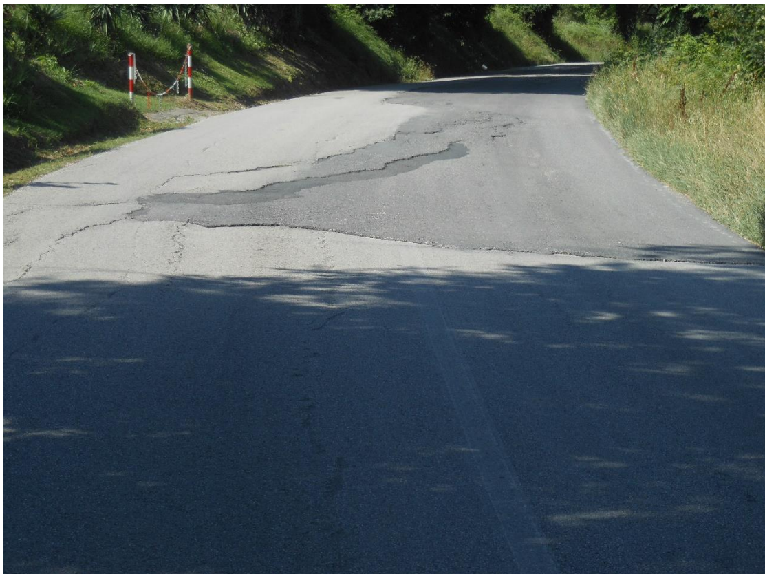
Foto 10. Km 14+700 - Avvallamenti della pavimentazione stradale con distacchi dello strato di usura.
