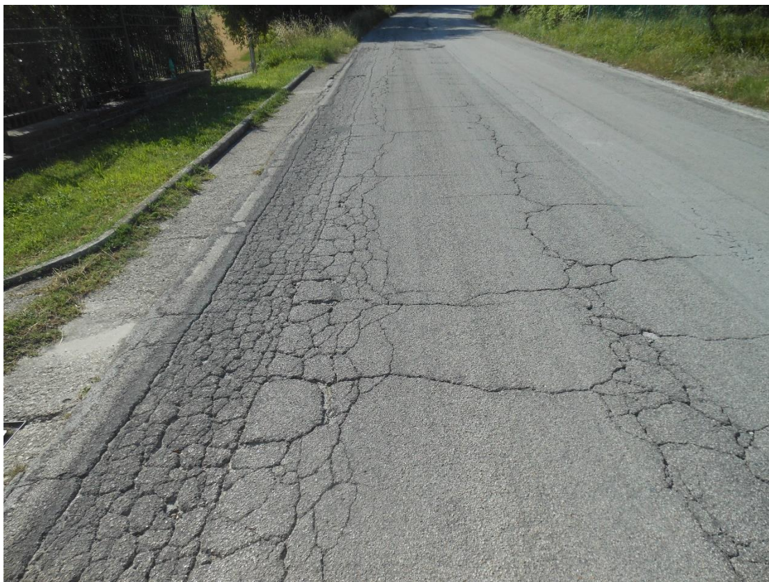
Foto 4. Km 4+500 - Fessurazione a blocchi della fascia centrale e fessurazione a ragnatela del bordo della pavimentazione stradale.
