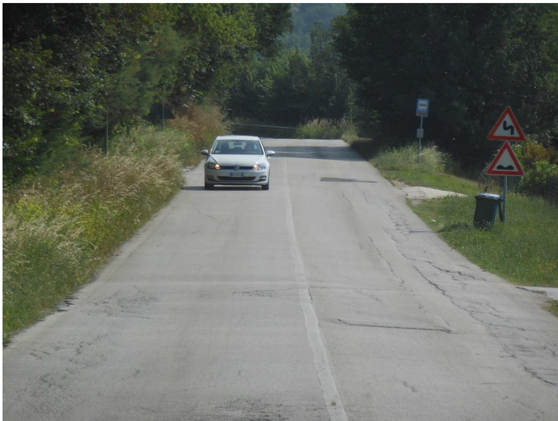
Foto 3. Km 2+700 - Avvallamenti della pavimentazione stradale connessi alla realizzazione di sottoservizi, fessurazione del bordo ed usura dello strato superficiale.
