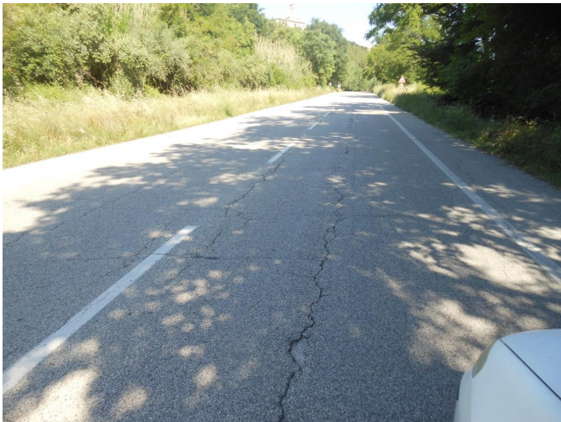
Foto 2. Km 2+100 - Fessurazione longitudinale della pavimentazione stradale.
