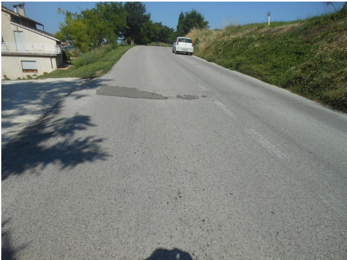
Foto 6. Km 8+100 - Fessurazione trasversale della pavimentazione stradale.
