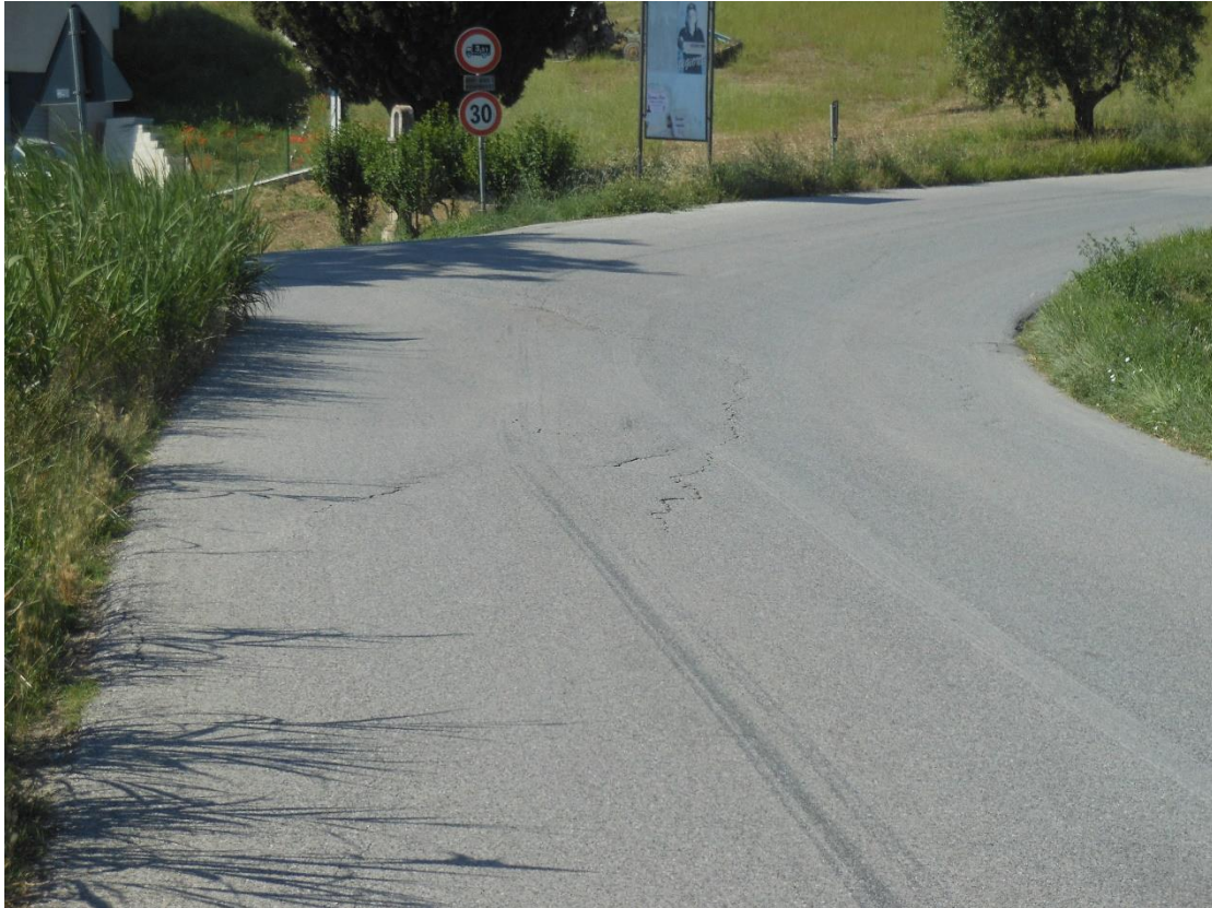
Foto 7. Km 8+600 - Fessurazione della pavimentazione stradale.
