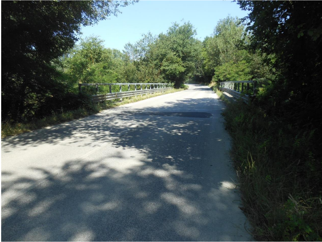
Foto 11. Km 15+200 - Avvallamento della pavimentazione stradale in prossimità del ponte.
