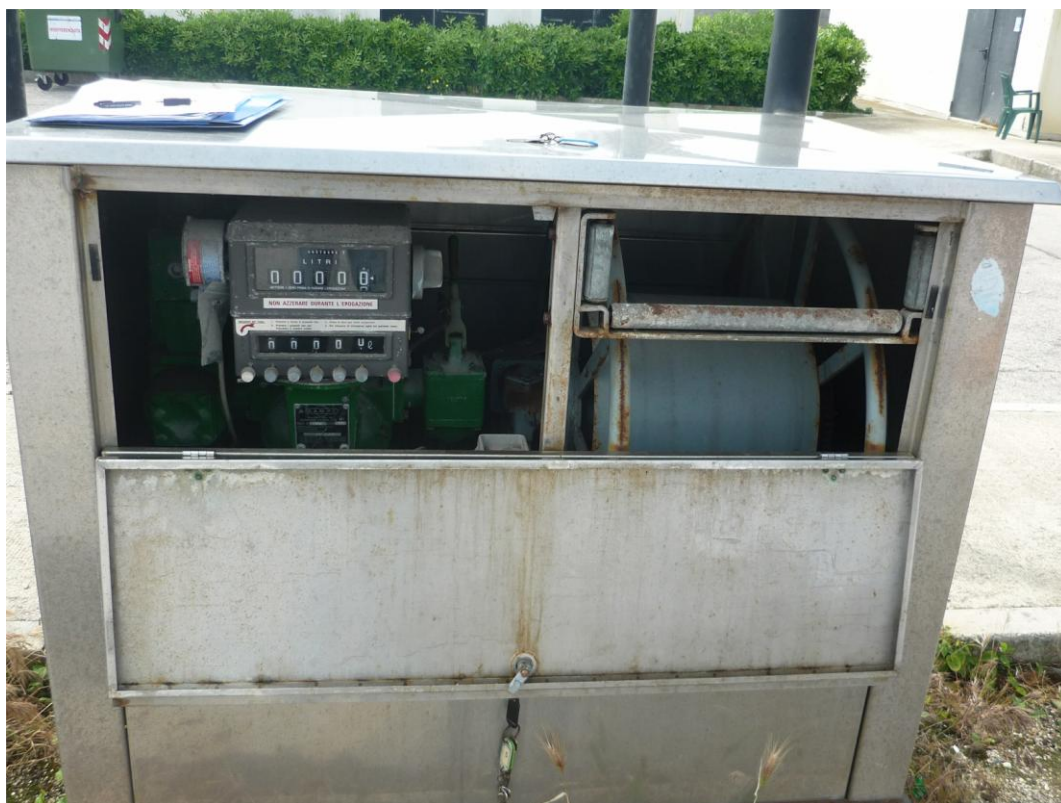
FOTO 5 – CONTATORE ED INTERNO IMPIANTO DI EROGAZIONE N. 1
