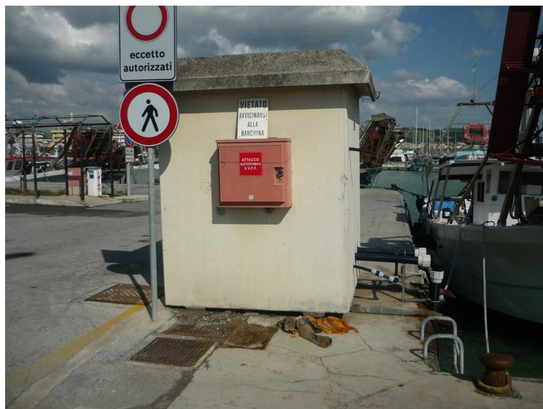
FOTO 10 – BOX PREFABBRICATO IMPIANTO ANTINCENDIO – ATTACCO AUTOPOMPA
