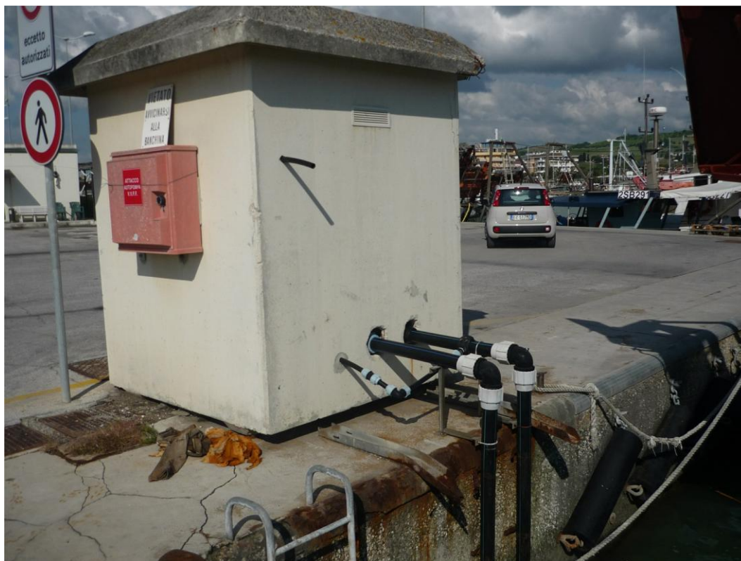
FOTO 11 – BOX PREFABBRICATO IMPIANTO ANTINCENDIO – PARTICOLARE PRELIEVO ACQUA DAL MARE
