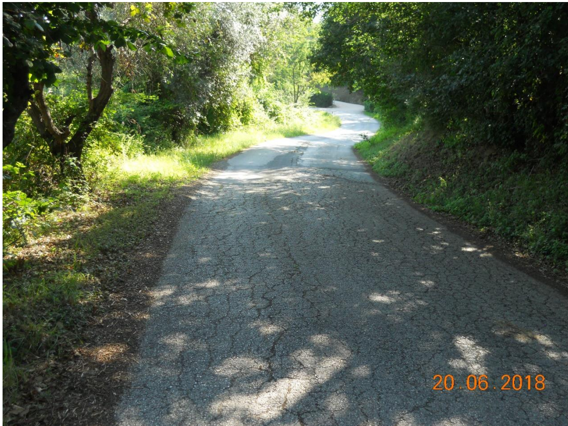
Foto 5. Km 5+800 - Avvallamenti della pavimentazione stradale con fessurazione a ragnatela dello strato superficiale.
