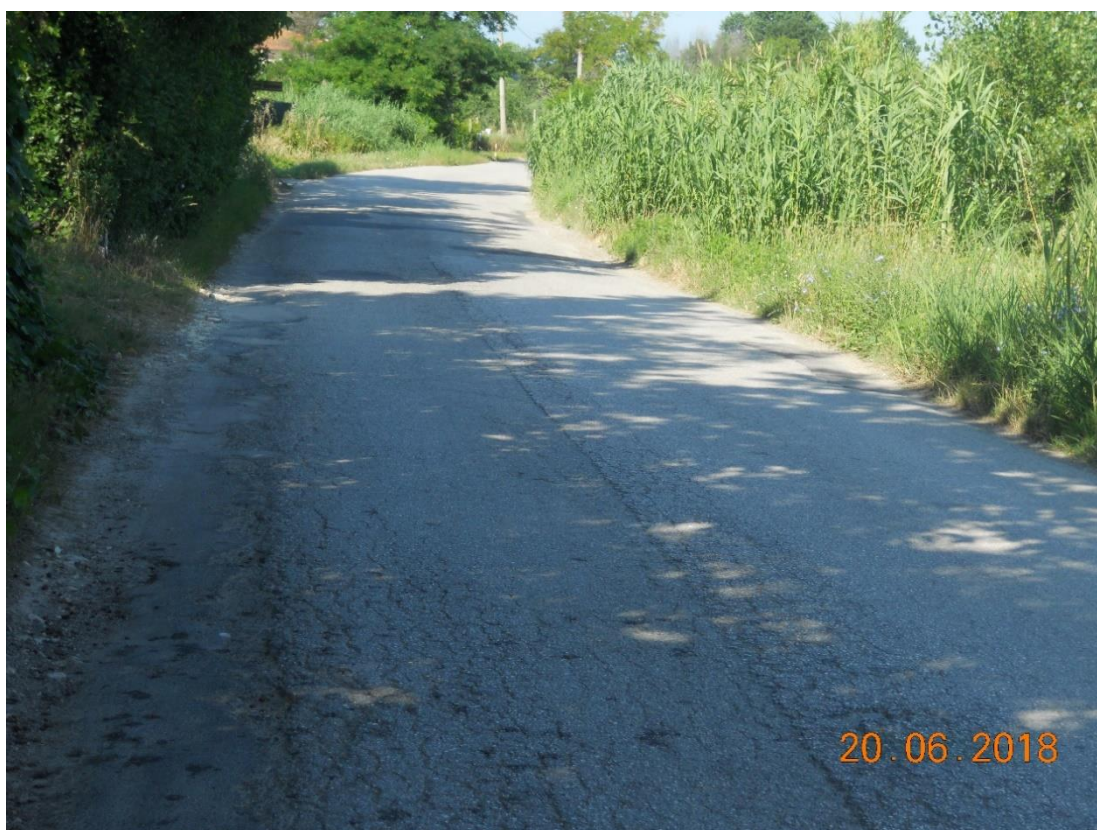
Foto 1. Km 1+400 – Degrado avanzato del bordo della pavimentazione stradale con sgranamento e fessurazione diffusa.
