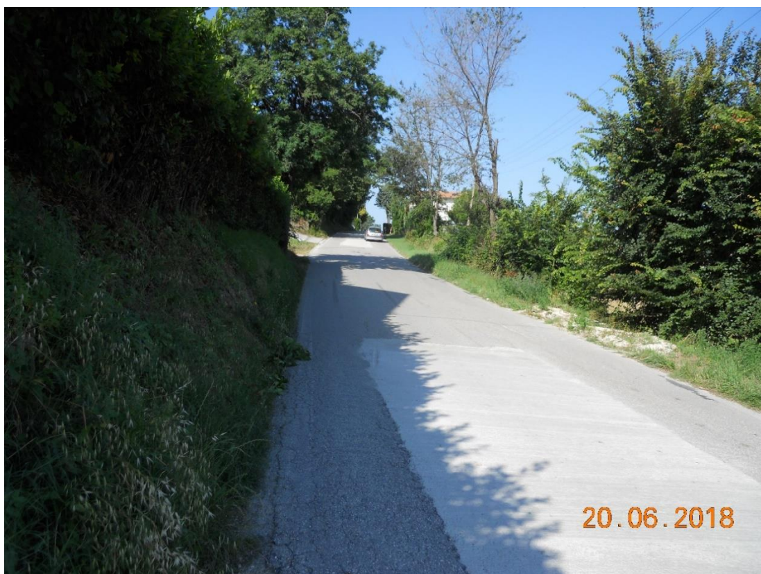
Foto 1. Km 0+900 - Discontinuità del piano viario con fessurazione del bordo della pavimentazione stradale.
