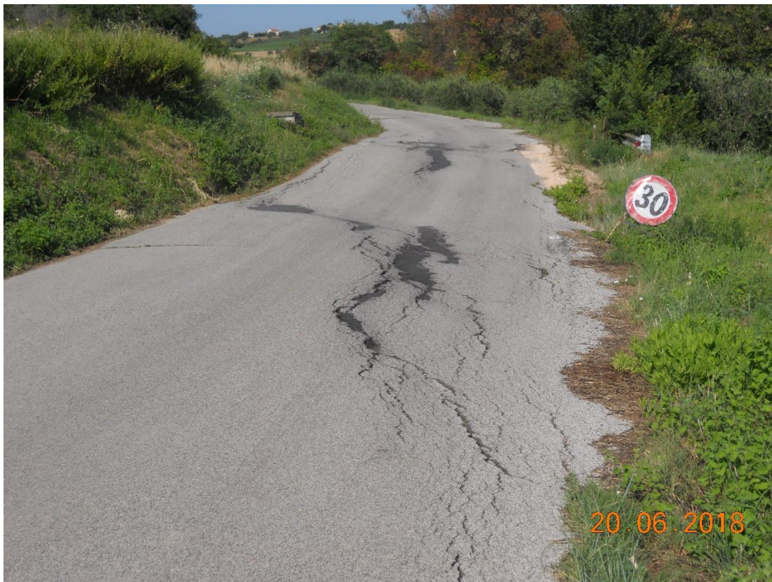
Foto 3. Km 4+800 - Avvallamenti della pavimentazione stradale con fessurazione trasversale.
