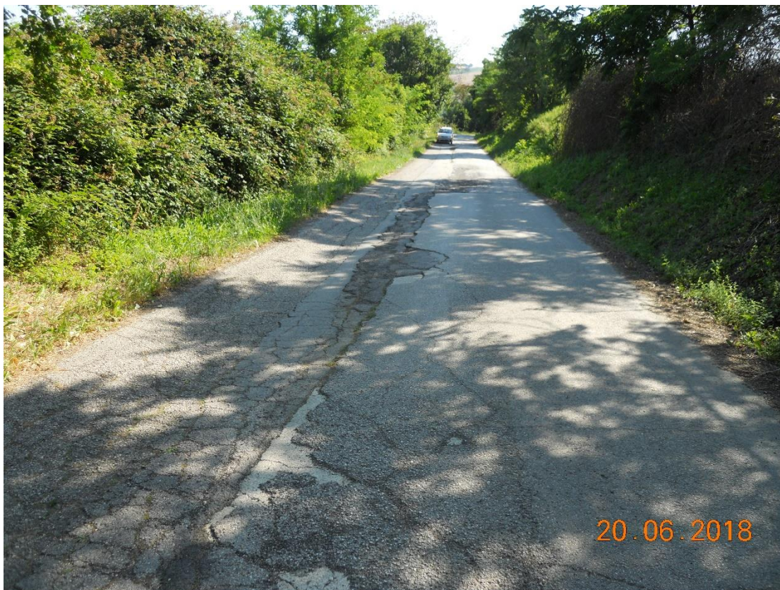
Foto 4. Km 5+200 - Avvallamenti della pavimentazione stradale, fessurazione a ragnatela dello strato di usura, deterioramento e distacco dei rappezzati.
